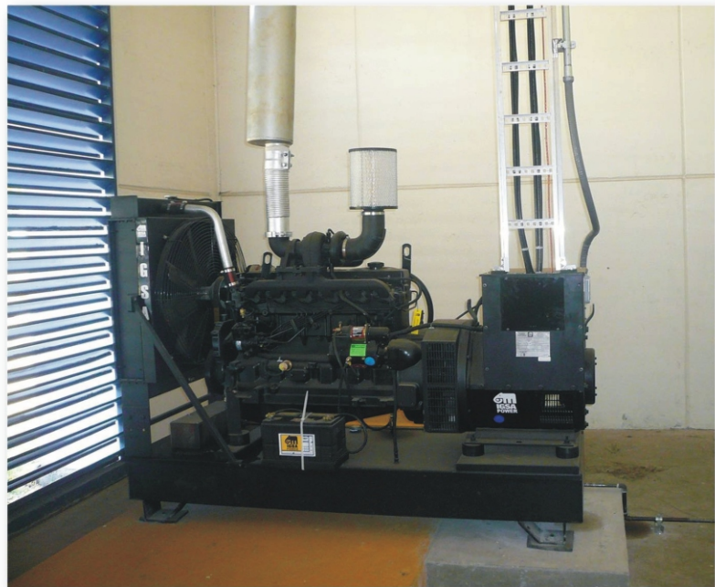
Planta de Emergencia
