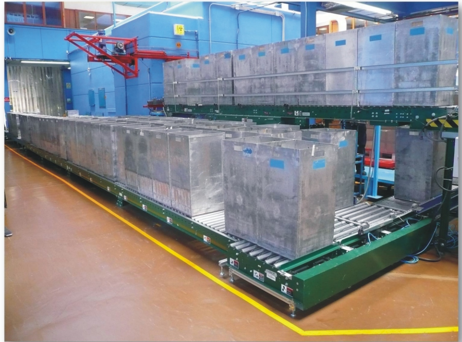
Modernización de transportadores de contenedores
